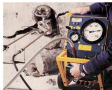
Bursting 逼裂混凝土
